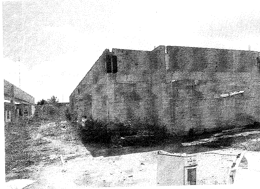
Figura 02 – Serviços Realizados e Inacabados
