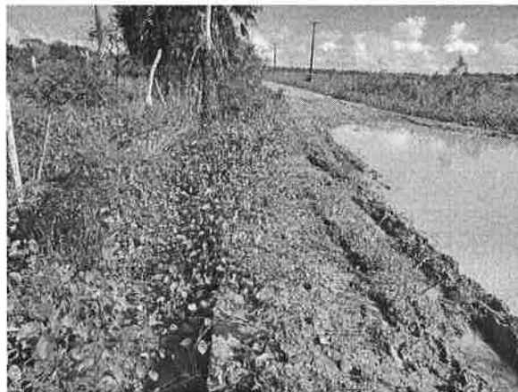
Passagem molhada- Avenida B
